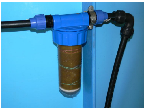
Fig.37 Filtru mecanic cu site
